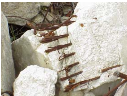
Figura 4. Escombros de concreto reforzado.
